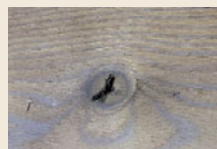
Uitbrekende kwasten en ruwe plekken aan kwasten
