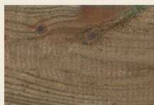
Ruwe plekken op het houtoppervlak
